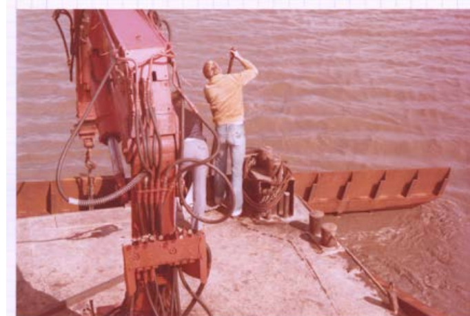
Réglage du bouclier en fonction de la hauteur d'eau
