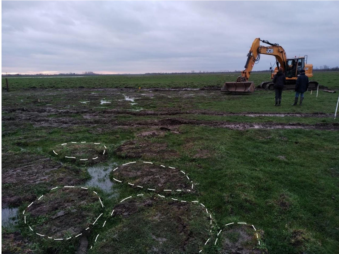
Figure 2. Opération d'aplanissement de mottureaux. Au premier plan, on devine les empreintes des mottureaux aplanis indiqués en traits pointillés blancs.
